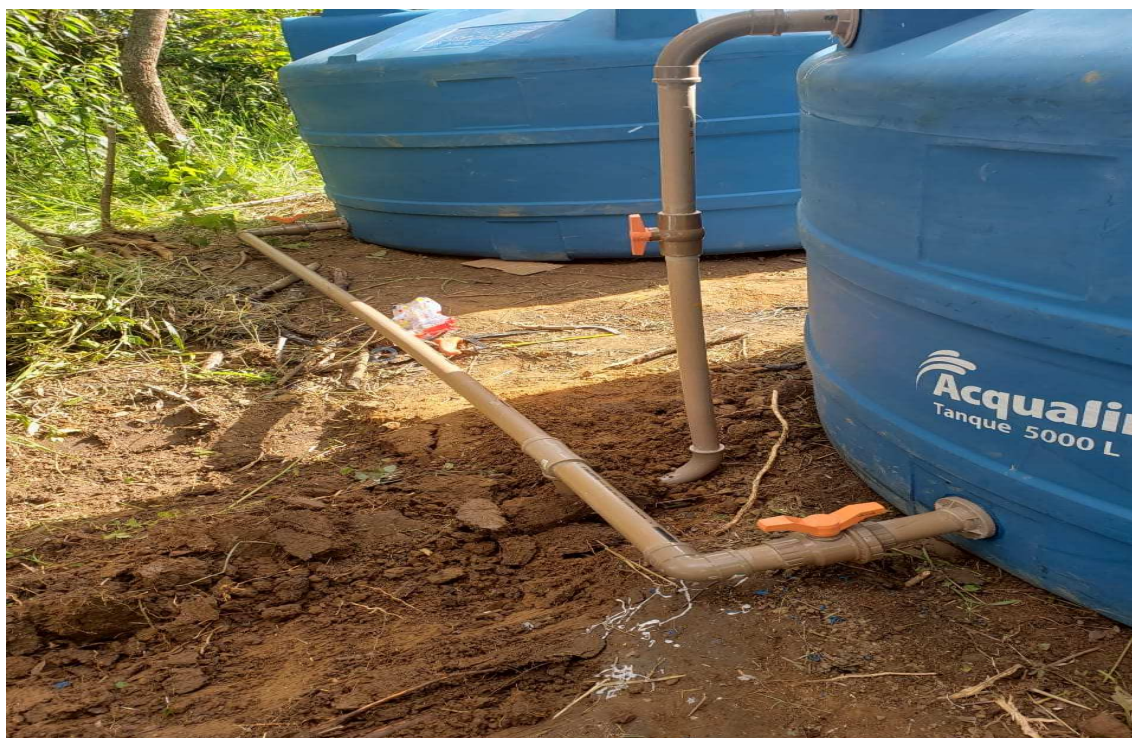
Figura 4 – Caixas de coleta de água do poço.
